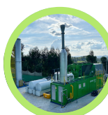
UNIDADE DE GERAÇÃO DE ENERGIA A PARTIR DO BIOGÁS (TERMOVERDE)
